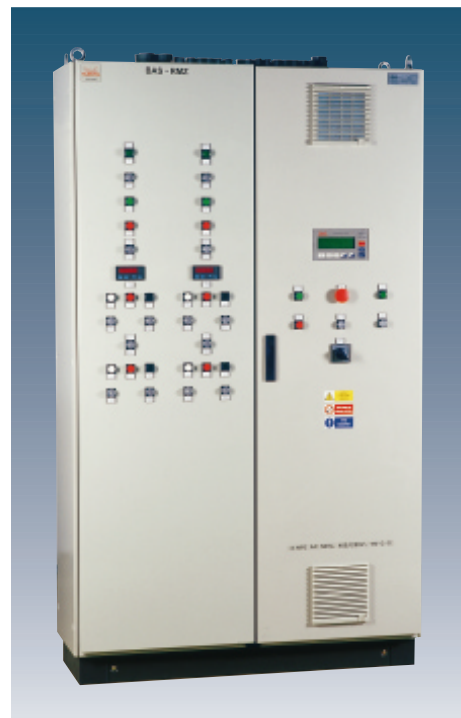
Řídicí část pro modulové elektroodlučovače BAS-RMZ, vybavená řízením 2 ks kouřových ventilátorů
